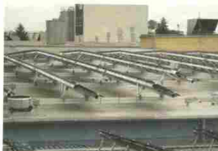
Die Anordnung der vom Dach entkoppelten Leichtbau-Modulkonsolen gewährleistet den verschattungsfreien Sonnenlichteinfall auf die PV-Module.
